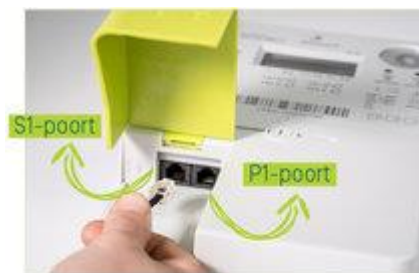
Figuur 10 – 'P1'- en 'S1'-poort van de digitale meter
